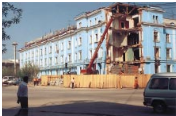
Рис. 1. Типичный пример частичного обрушения кирпичных и блочных зданий (г. Якутск; фото М.Н. Григорьева)
