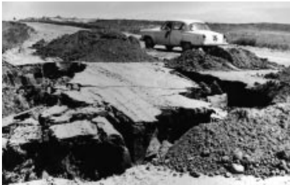
Рис. 2. Разрушение дорожного полотна шоссе, проложенного на лёссовых породах около г. Ашхабада.
